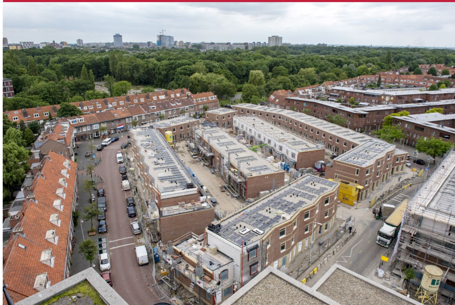
Sloop- nieuwbouwproject Haagse Hendrik. Hier wordt de voorloper van het Slimm concept toegepast.
